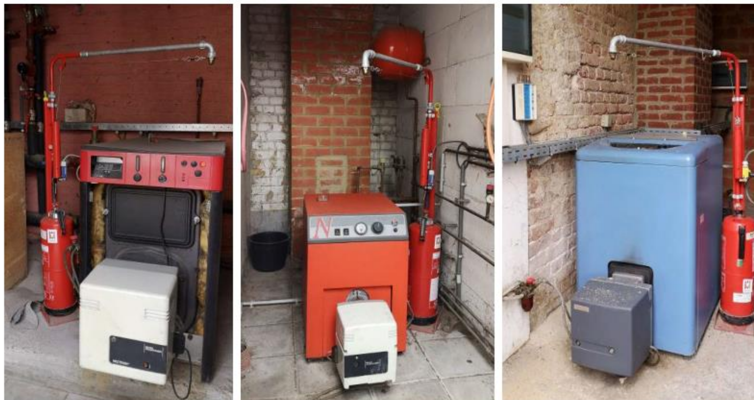
Les 3 chaufferies au mazout desservant les 6 logements de la régie foncière communale
