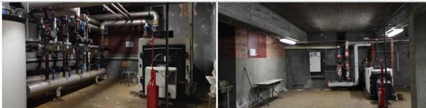
Les chaufferies au mazout actuelles de l'école communale, Aile « Cuisine » et Aile « Fond » (de G à Dr)
